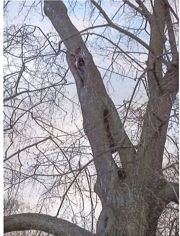
Fot. 4 Lipa szerokolistna, ul. Nad Jeziorem, Tychy; widoczne wloty do ubytku kominowego biegnącego od odziomka do górnej części przewodnika nr 3
